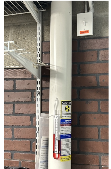
Manometer and fan switch
